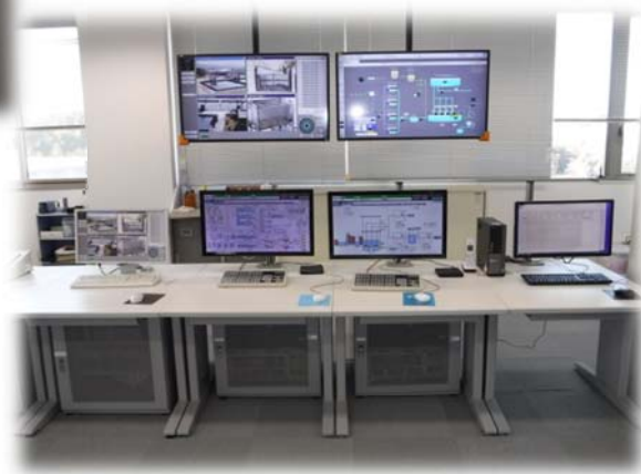
中央監視設備（三口浄水場）
