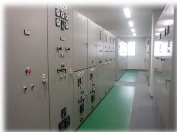
受変電設備（三口浄水場）
