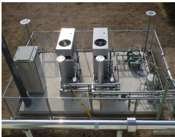
(発電設備 プラント全景)
