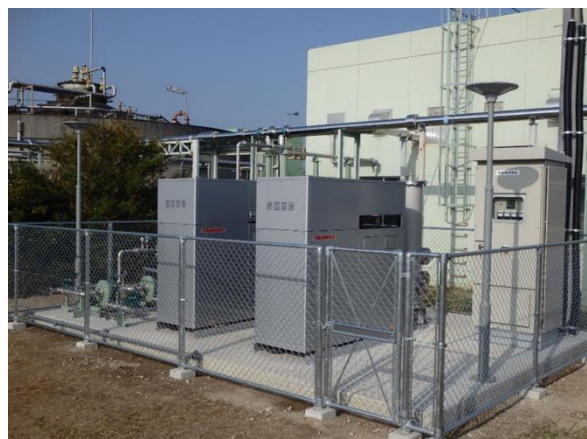
(発電機・発電基盤)
