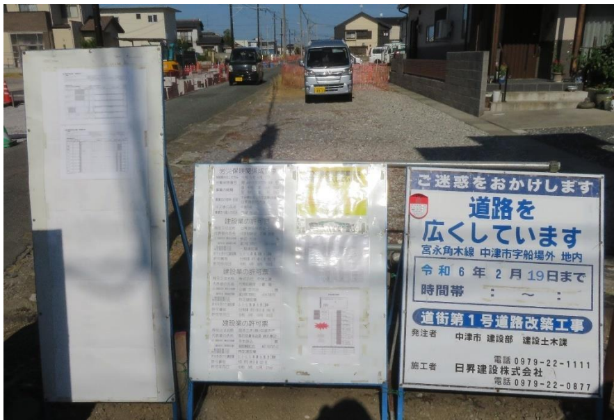
現場掲示物（掲示内容に問題は無いが、施工体系図が小さく読みづらい）
